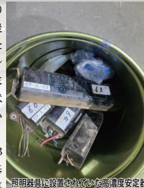
照明器具に設置されていた高濃度安定器
