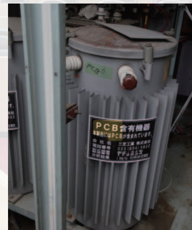
高濃度PCBが使用されているトランス
